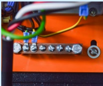
Figura 5 - Barra de aterramento do Painel
