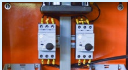
Figura 7 - Posição dos disjuntores no painel
