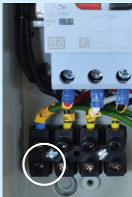
Figura 6 - Ponto de aterramento do Painel
