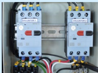
Figura 8 - Posição dos disjuntores no painel
